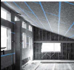
Lors de la construction d'une maison à ossature bois (ici isolée en paille), l'étanchéité à l'air entre panneaux est assurée par la pose d'un ruban adhésif.
